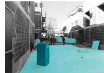
Realizzazione della pendenza e dell'isolamento termico di un solaio calpestabile di un condominio con due piani sotterranei
