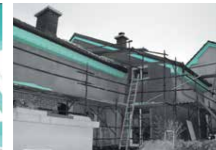
Sporti di gronda realizzati con pannelli FIBRANxps ETICS. Lo spessore dipende dalla campata.
