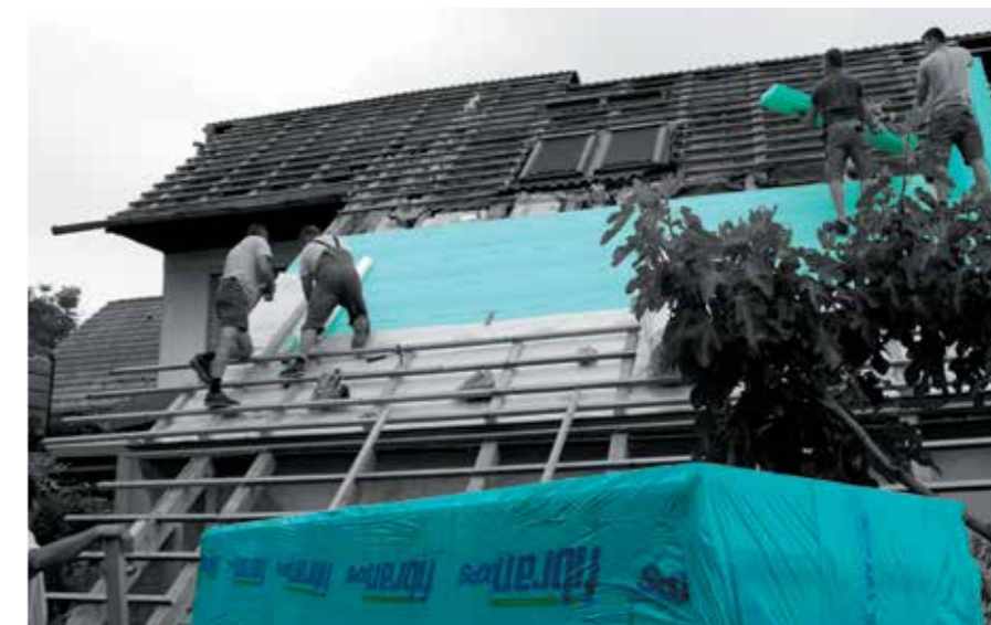
Trasformazione di un sottotetto in una mansarda abitabile realizzata con la membrana riflettente FIBRANskin VENT SILVER ed i pannelli termoisolanti FIBRANxps MAESTRO
