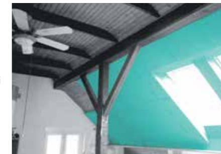
Realizzazione di isolamento termico dall'interno con pannelli FIBRANxps ETICS, che verranno intonacati o verniciati.
