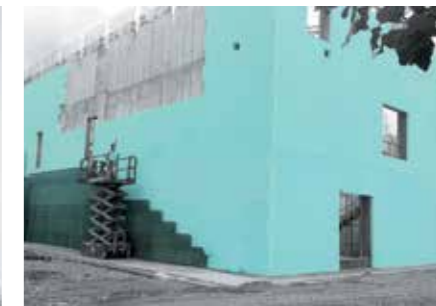
Pannelli FIBRANxps MAESTRO in intercapedine mentre viene eseguito il paramento esterno di facciata con cemento a vista
