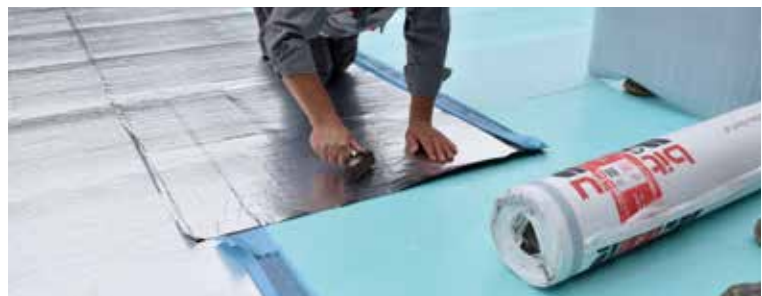
Posa dell'eventuale primo strato di impermeabilizzazione (in figura tipo FIBRANhydro ANTI RADON 1,5sk) perpendicolarmente al primo strato di pannelli FIBRANxps (preventivamente puliti e asciutti). Le sovrapposizioni devono essere larghe almeno 15 cm.
