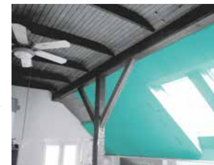
Realizzazione di isolamento termico dall'interno con pannelli FIBRANxps ETICS , che verranno intonacati o verniciati.
