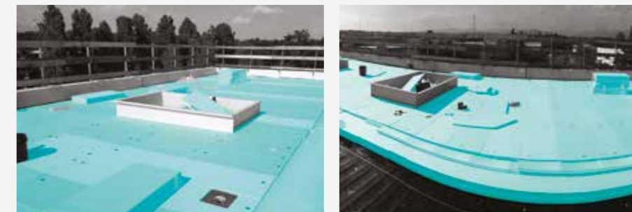
Realizzazione dell'inclinazione con pannelli FIBRANxps INCLINE e fissaggio di pannelli FIBRANxps su un tetto privo di protezione pesante.
