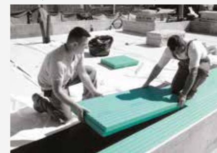
I pannelli FIBRANxps SEISMIC vengono posati con precisione estrema sulla superficie superiore adesiva della membrana FIBRANhydro SEISMIC T-1,8 sk/sk .
